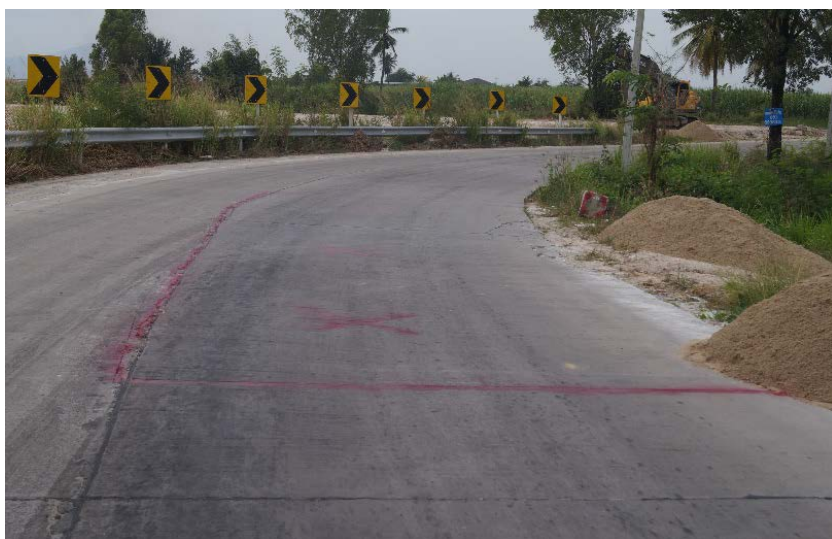
รูปที่ 4 สภาพถนนก่อนการซ่อมบำรุง
