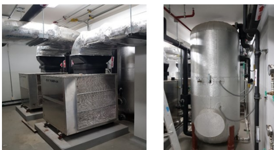
ภาพที่ 2 ระบบฮีทปั๊มซึ่งใช้งานอยู่ปัจจุบัน
