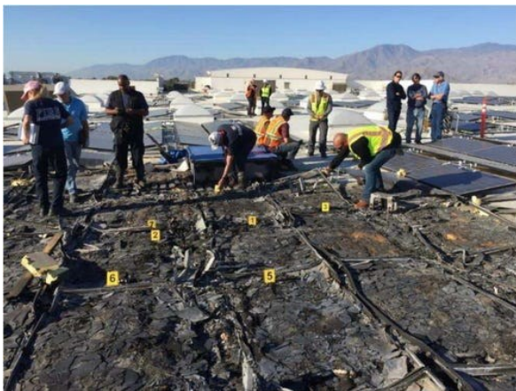
รูปที่ 1 ภาพหลังคาอาคารวอลมาร์ท ที่เกิดเหตุอัคคีภัยจากแผงโซลาร์เซลล์
