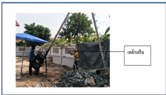
ภาพที่ 2.3 การนำเหล็กเสริมคอนกรีต ลงหลุมเจาะ - กิจกรรมการเทคอนกรีตและถอนปลอกเหล็กชั่วคราวป้องกันดินพัง เมื่อทำการเทคอนกรีตถึงระดับ 5.00 เมตร ถึง 3.00 เมตร จากระดับดินปัจจุบันจะทำการอัดลมเพื่อให้คอนกรีตแน่นมากขึ้น จากนั้นจึงทำการเทคอนกรีตต่อจนถึงระดับที่ต้องการจนเสร็จเรียบร้อยและทำการถอนปลอกเหล็กชั่วคราว ป้องกันดินพังออกทีละท่อนโดยใช้ความดันจากเครื่องอัดลมช่วยในการถอนประมาณสองถึงสามปลอกจนเห็นว่าแรงค้ำระหว่างปลอกเหล็กกันดินพังกับดินเหลือน้อยแล้ว จึงสามารถดำเนินการถอนปลอกเหล็กชั่วคราวป้องกันดินพังโดยตรงได้ ทำกิจกรรมนี้จนเสร็จ
