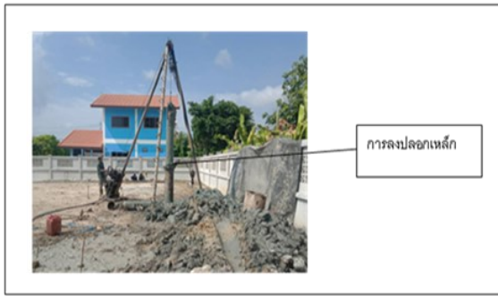
ภาพที่ 2.2 การขุดเจาะและลงปลอกเหล็กชั่วคราวกันดินพัง - กิจกรรมนำเหล็กเสริมคอนกรีตลงหลุมเจาะ หลังจากขุดเจาะถึงระดับที่ต้องการ และทำการตรวจสอบสภาพกันหลุมและความลึกเสร็จแล้วทำการลงเหล็กเสริม โครงการที่ศึกษาวิจัยในครั้งนี้กำหนดให้ใส่เหล็กเสริม ขนาด DB 16 mm. SD 30 จำนวน 8 เส้น ยาว 23.00 เมตร และใช้เหล็กปลอก RB 9 mm. @ 0.20 เมตร ยาวตลอดโดยแบ่งความยาวของเหล็กเสริมออกเป็นสองท่อน ต่อโดยวิธีการทาบ
